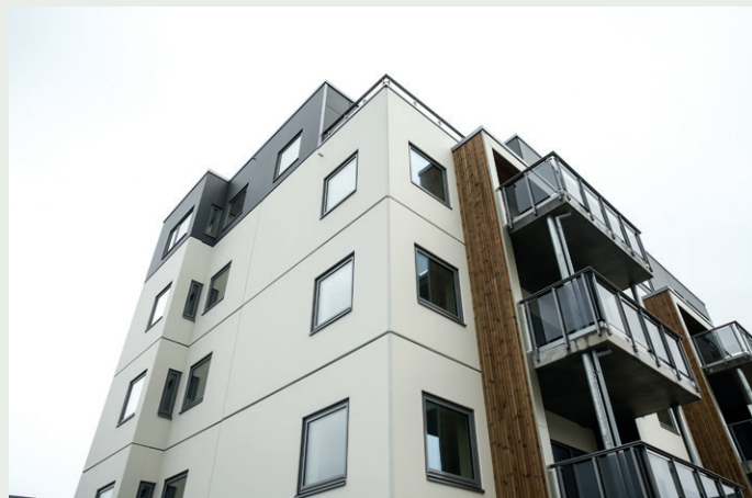
Malte betongelementer fra Elementpartner, vinduer fra Nordvestvinduet og glassrekkverk fra Vatnesenteret på denne delen av fasaden.
