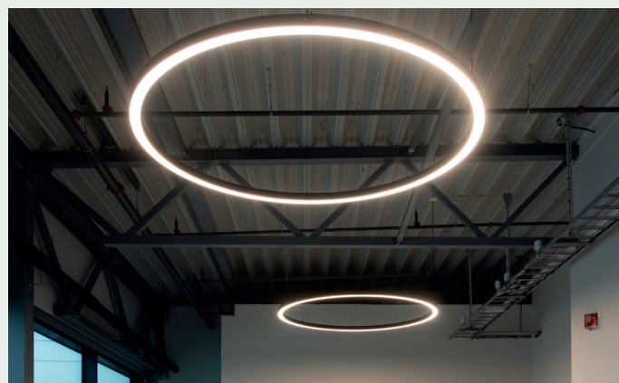
Spesiell belysning i andre etasje.
