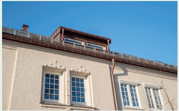
Taket på Administrasjonsblokka er gjenskapt med stein fra samme skiferbrudd som det gamle taket, og kobberbeslag er gjenskapt med tradisjonelle metoder.
